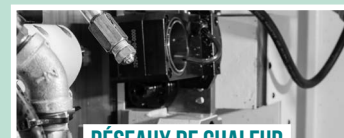
RÉSEAUX DE CHALEUR
